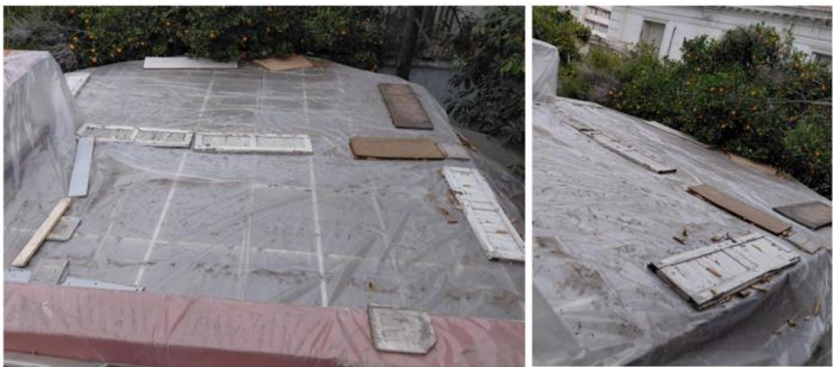
Ampliaciones precarias, con deficientes condiciones de habitabilidad y desempeño térmico.
