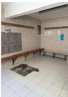
CAMARINES EN MUY MAL ESTADO Y CON BAJA CAPACIDAD
