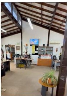
OFICINAS ANTIGUAS, CON PROBLEMAS DE FILTRACIÓN Y ELÉCTRICOS
