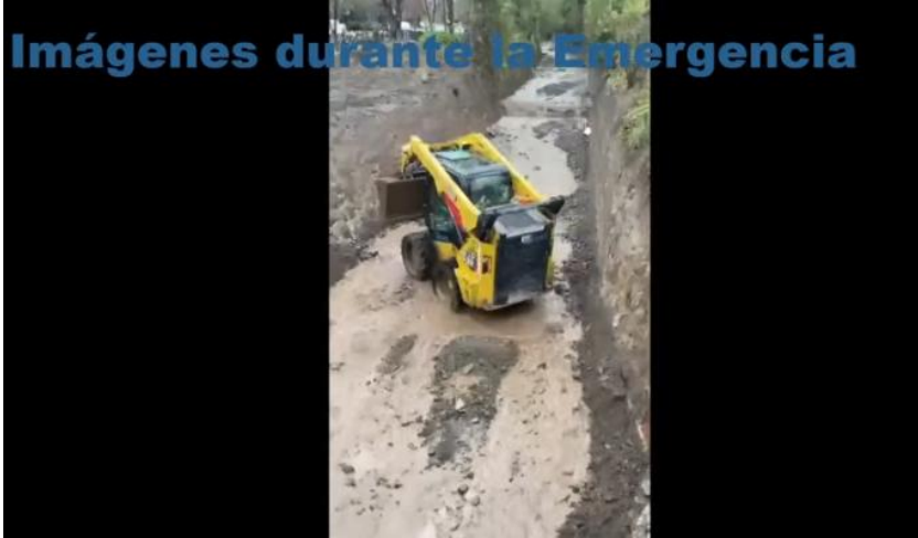
Imágenes durante la Emergencia
