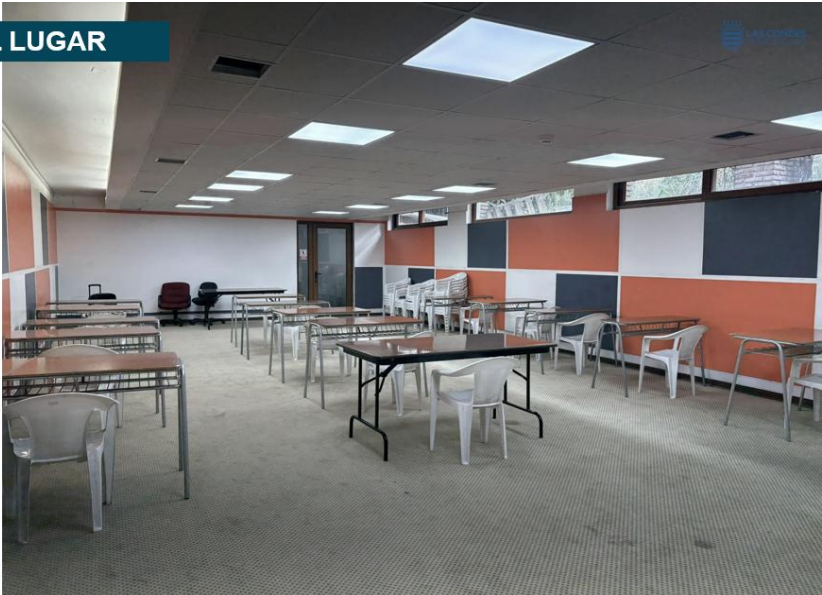
Infraestructura y mobiliario en estado de deterioro.
