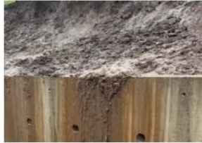
Riesgo de erosión de terreno
