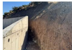
Falta de rellenos de tras muro
