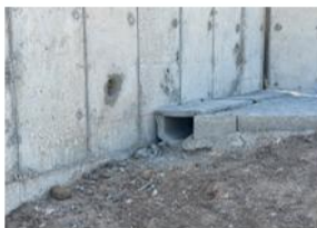
Carencia de solución de aguas lluvias y drenaje
