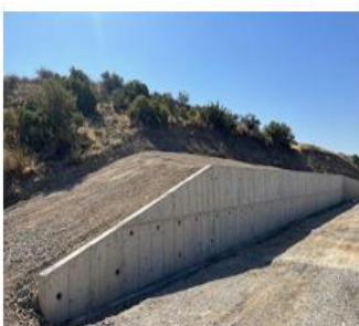
COMPLETAR RELLENO TRAS MURO FALTANTE
