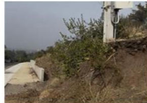
Muro de contención faltante en Camino el Observatorio
