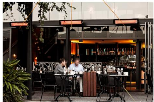
CALEFACCIÓN ADOSADA A MUROS DE FACHADA.
