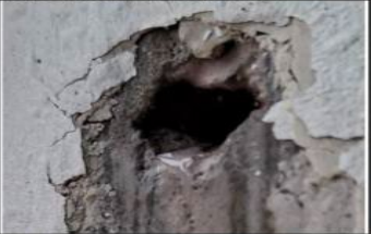
Filtración a través de perforación muro 205
