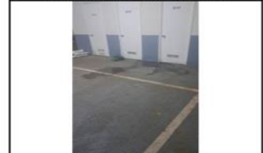
Filtración de aguas lluvia en bodegas -1
