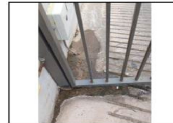
Filtración de agua en pilar portón de rampa
