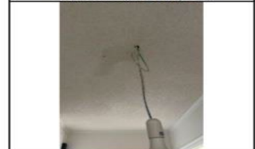
Manchas de humedad cielo dpto 1403
