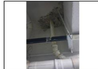
Filtraciones en descargas subti -1
