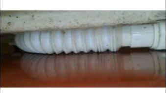
Filtración desagüe receptáculo dpto 801
