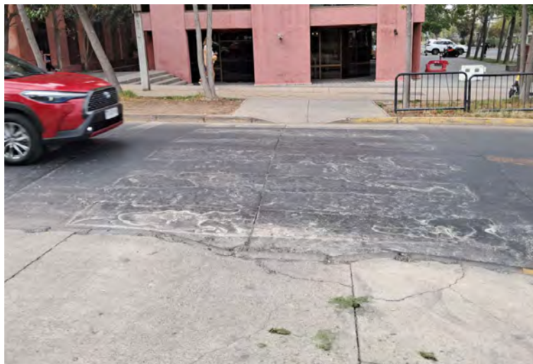
Acera Esquina Surponiente
