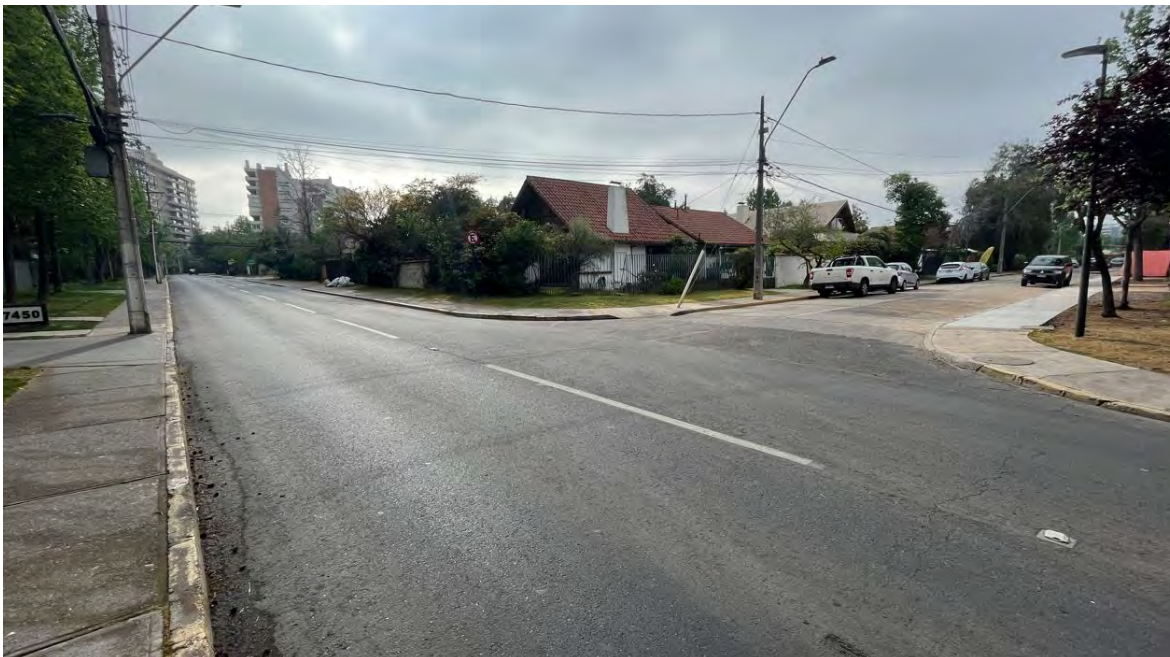
Figura 6-5. Catastro de Pavimentos, Cruce Christiensen con Hnos. Cabot
